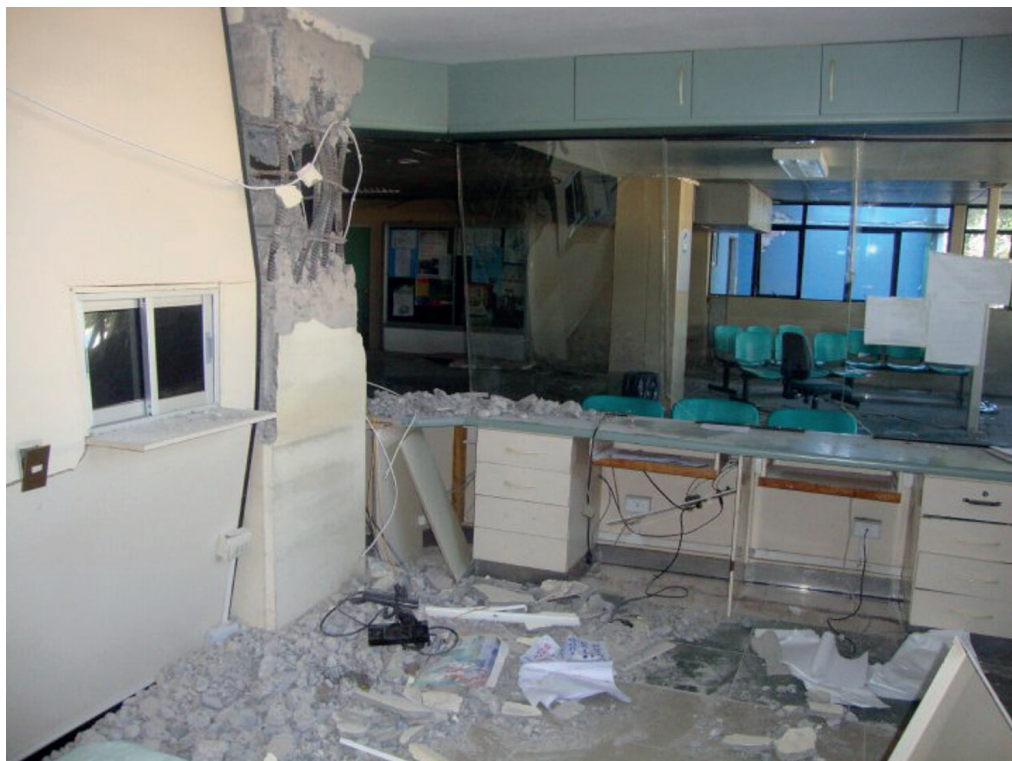
Figura 4. Foto tomada en la recién remodelada sala de recepción de urgencia la mañana del 28 de febrero de 2010, totalmente destruida por el megaterremoto de la madrugada anterior.
